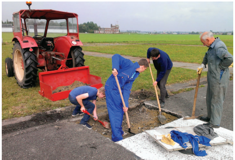
Het gat aan de baandrempel 06 wordt hersteld door clubleden van De Wouw
